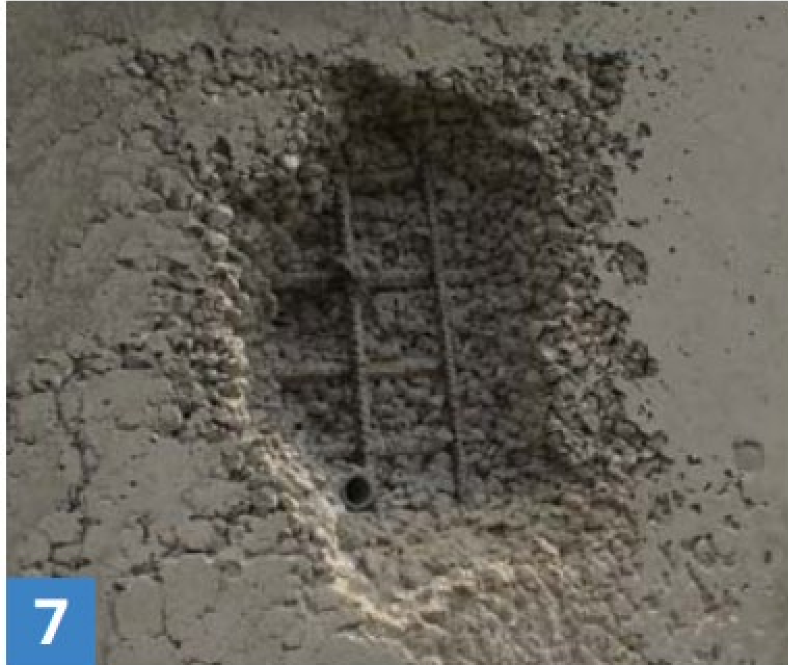
Obnažená armatura a štěrkové hnízdo
